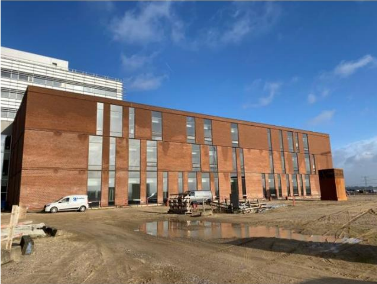
EKSEMPEL PÅ OPFUGTET FACADE I BASEBYGNING PÅ NYT AALBORG UNIVERSITETSHOSPITAL.
